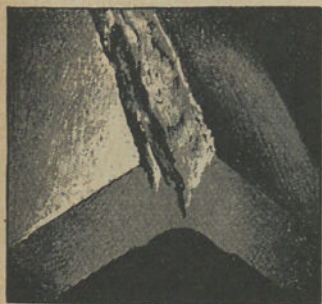
Fig. 52. - Ruptura da soldadura por falta de penetração.
