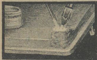
Fig. 132. - Colocação de um montículo de metal no canto de uma peça de ferro fundido.
